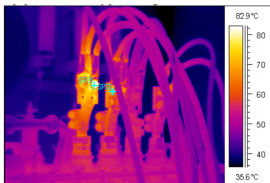
Slika 3. Termogram provodnog izolatora čije su neispravnosti na spoljašnjem priključku
